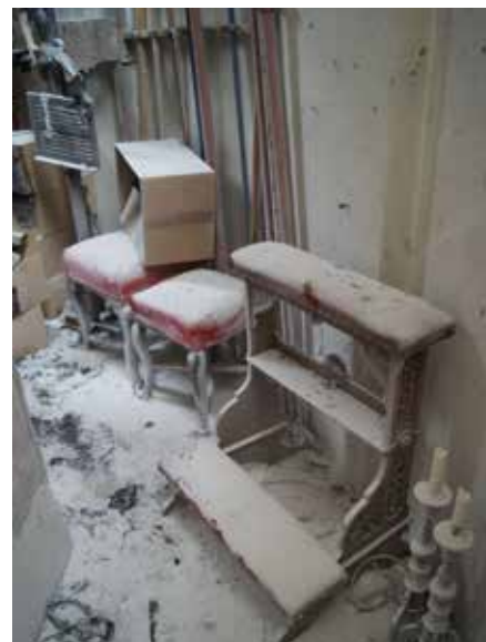
Das feine Pulver aus dem Feuerlöscher muss mühsam mit dem Staubsauger aus allen Ritzen entfernt werden.
