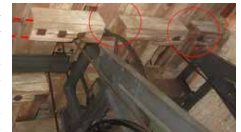
Die Schäden am Dachstuhl der Pfarrkirche St. Stephan wurden im Gutachten detailliert beschrieben und mit Fotos dokumentiert.
